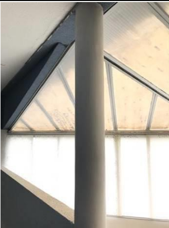
Photo n° PhA005 Localisation : Immeuble Niv 1 - Couloir distribution chambres Ouvrage : Murs, Cloisons "en dur" et Poteaux (périphériques et intérieurs) Partie d'ouvrage : Poteaux Description : Poteaux
