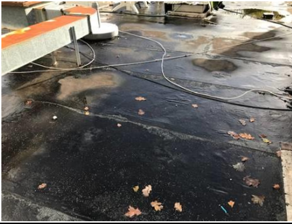
Photo n° PhA004 Localisation : Couverture Ouvrage : Toitures Partie d'ouvrage : Bardeaux bitumineux Description : Bardeaux bitumineux
