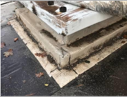
Photo n° PhA004 Localisation : Couverture Ouvrage : Toitures Partie d'ouvrage : Bardeaux bitumineux Description : Bardeaux bitumineux
